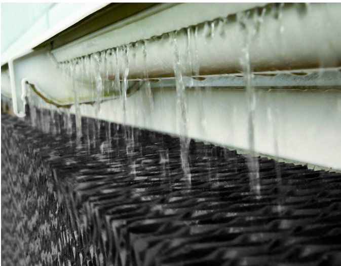
Wasserverteilung im Pad-Rahmensystem
